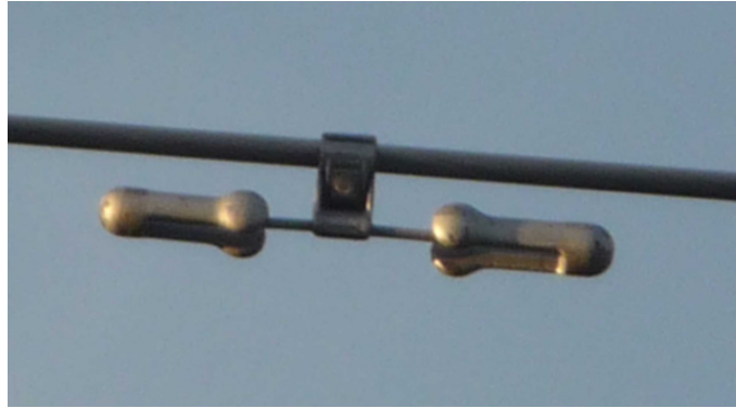
Abbildung 30: Stockbridge-Schwingungstilger an einem Hochspannungskabel
